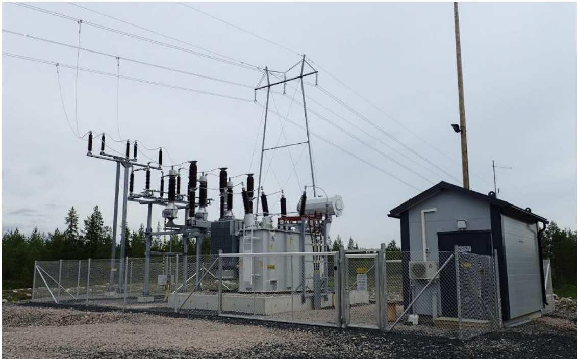
Kuva 16. Esimerkki tuulivoimapuiston sähköasemasta (Minna Takalo, FCG).
